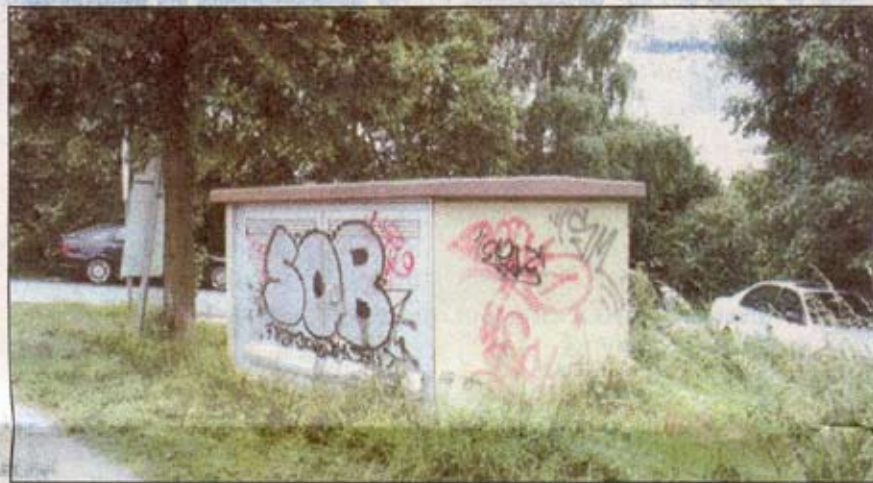
Vorher: Die willkürlich beschmierte Trafostation an der Bundesstraße 3 am südlichen Ortsausgang von Bensheim.
